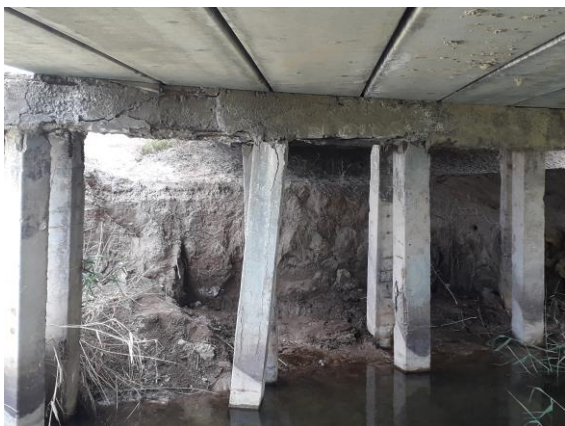
Рис. 3. Силовые трещины в сваях моста
