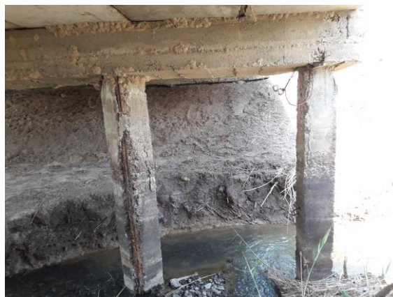
Рис. 4. Коррозия бетона по причине солевой агрессии автодорожного мост
